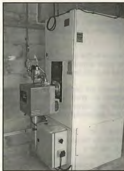
Chaudière au gaz de l'église
